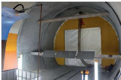
3 | Versuchsplatz Stollen «A» (links) mit Abluftreinigungs-vorrichtung (rechts). 3 | Site d'essai de la galerie «A» (à gauche) avec son dispositif d'assainissement de l'air pollué (à droite).
